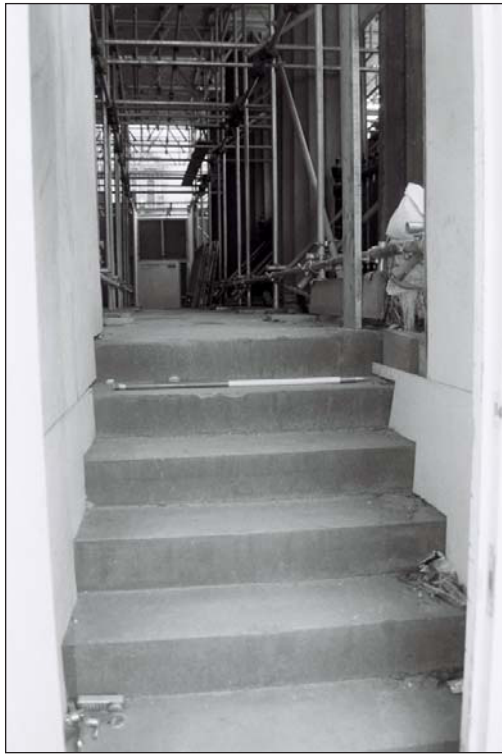
○ 階段のコンクリート打設完了後、階段の養生を撤去し、階段の清掃を行った。
