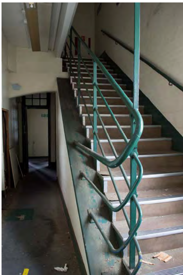
Plate 22: Modified stair railings (SJH81-0095)
