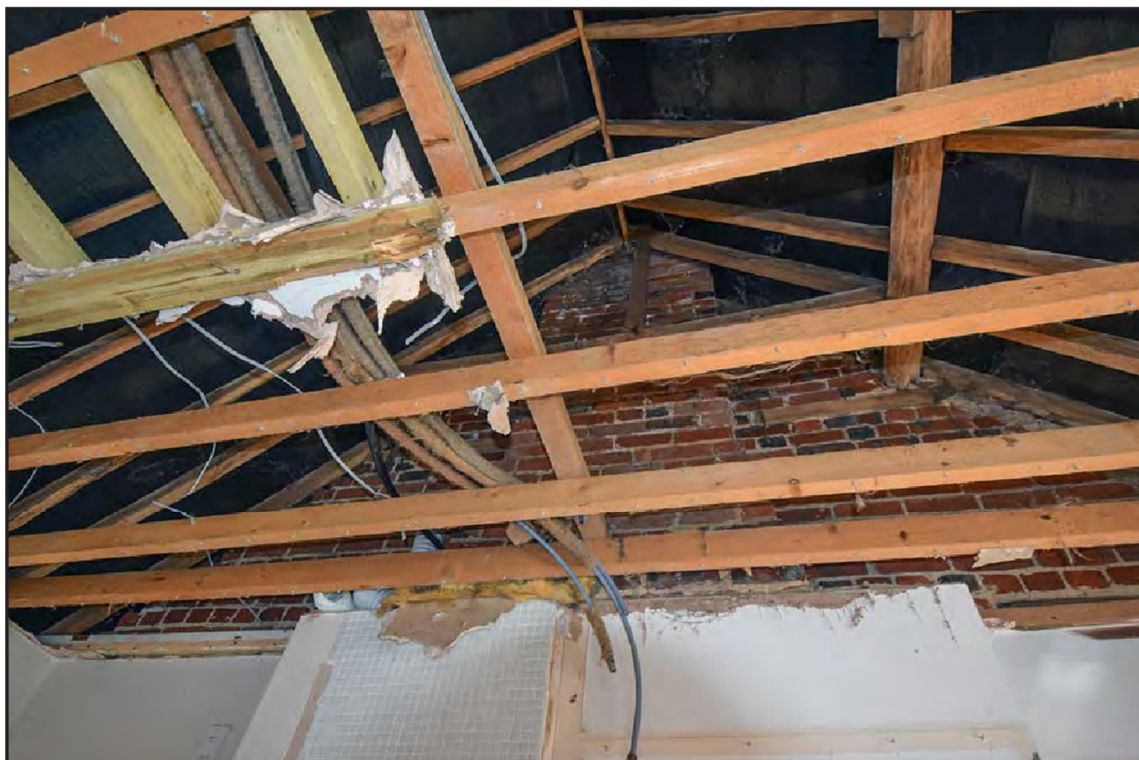
Photo A- 39: Exposed roof structure, bedroom F1
