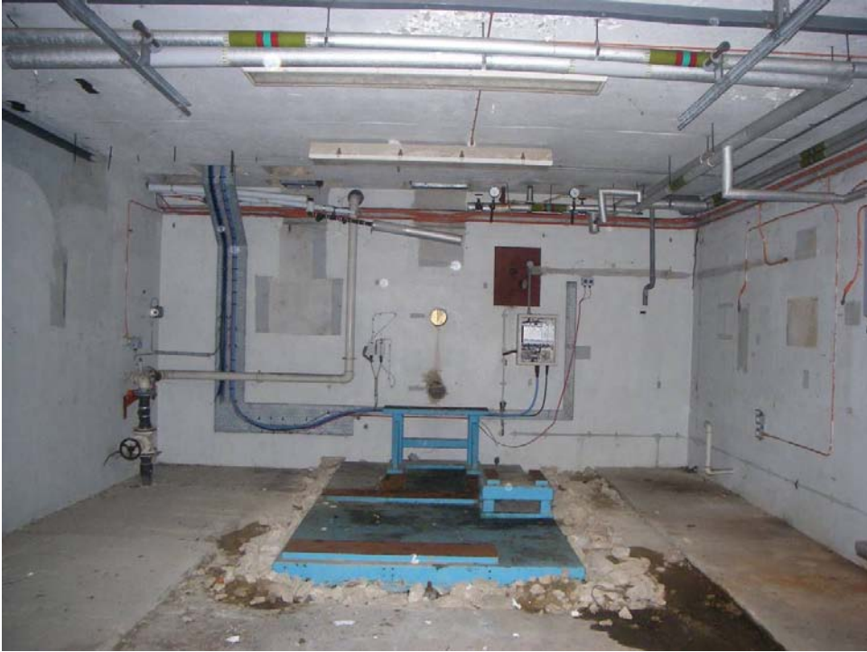
a) SPA48 (pugmill) interior
