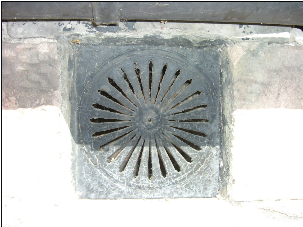
Fig. 81: Ventilation grill (WN_MP 022)
